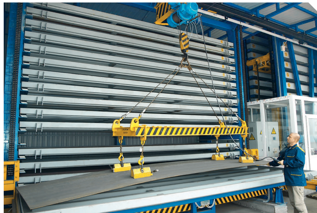
Автоматизированный склад листового металлопроката
