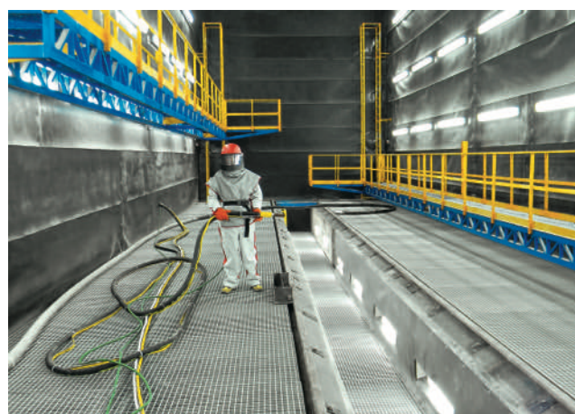
Дробеструйная камера с подъемными площадками
