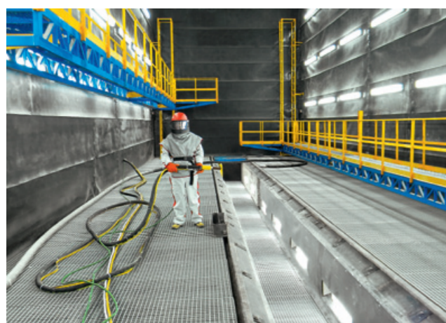
Дробеструйная камера с подъёмными площадками
